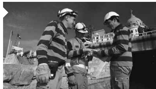
Équipe réalisant une intervention sur le réseau pluvial de la ville de Nice.
